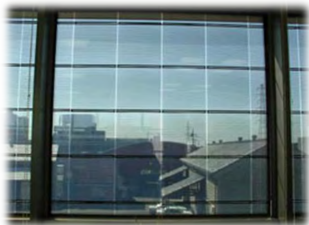
シースルーアモルファス太陽電池（太田市役所HPより）
