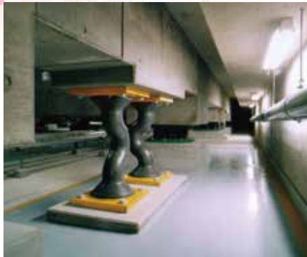
23号館地下に設置された免振装置
